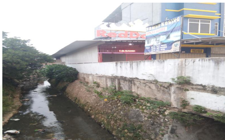
Gambar 3. Pelanggaran bangunan di bantaran Sungai Way Awi di Jalan Imam Bonjol Kecamatan Tanjung Karang Barat.
