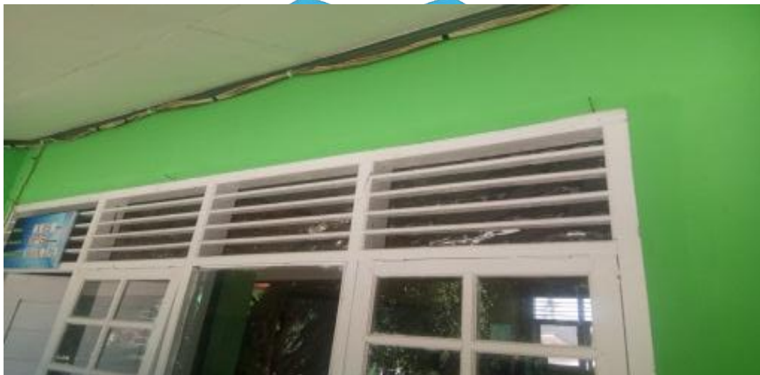
Dokumentasi ventilasi di SMA Yasmida Ambarawa
