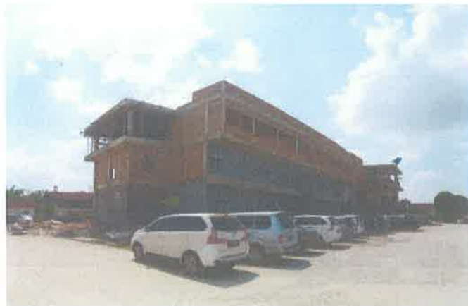
Proses Pembangunan Gedung Rumah Sakit Yukum Medical Centre Bagian Samping Sebelah Timur
