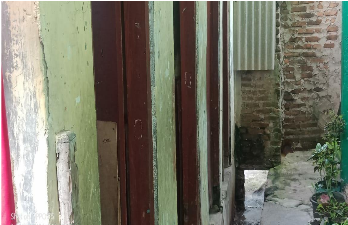
Foto Kondisi WC Umum Siswa
